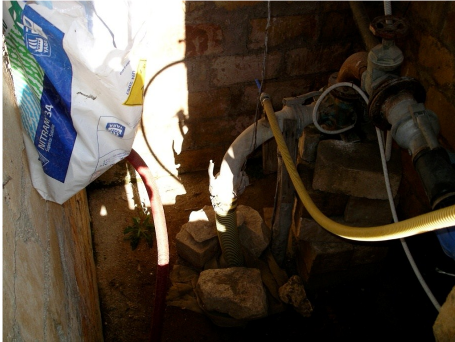
Figura 4-3 Particolare della condotta di mandata del pozzo a servizio dell'azienda A3
