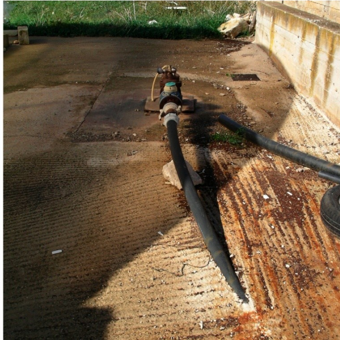
Figura 4-2 Particolare della condotta di mandata del pozzo a servizio dell'azienda A1
