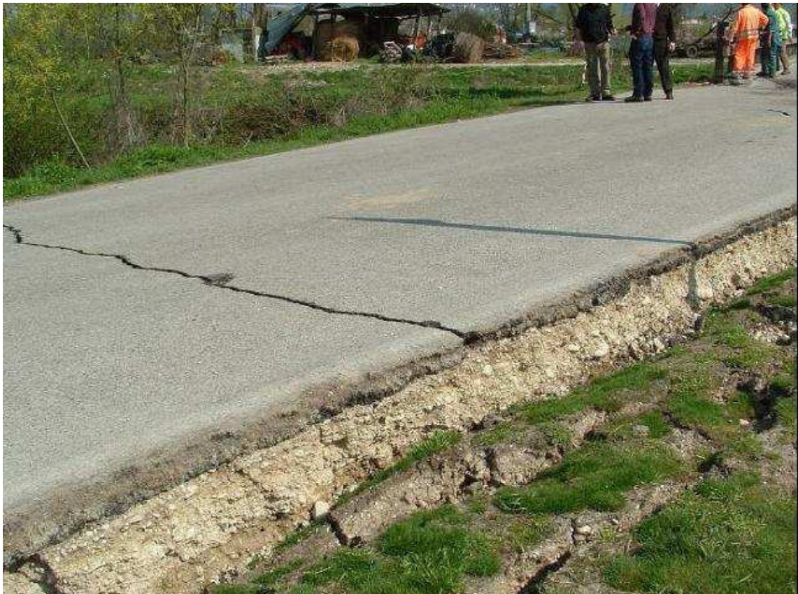
Figura 5.1 – Deformazioni verificatesi lungo una sede stradale.
