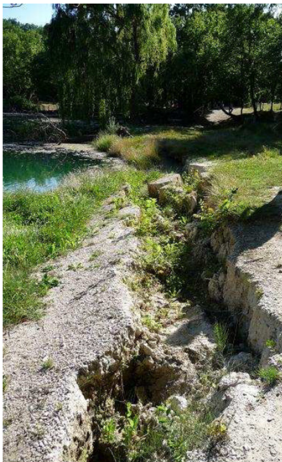
Figura 5.2 – Deformazioni verificatesi lungo una sede stradale.
