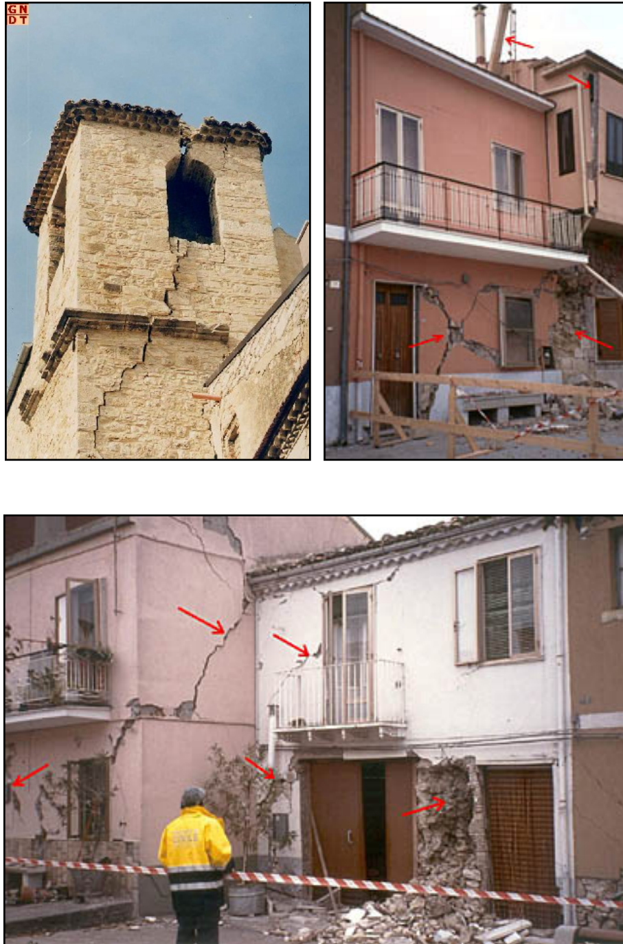
Figura 4.7 – Danni subiti da alcuni edifici a seguito del terremoto del 31 ottobre 2002.
