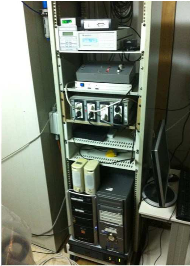
Figura 1.23: Il rack dell'elettronica di controllo di CAOS
