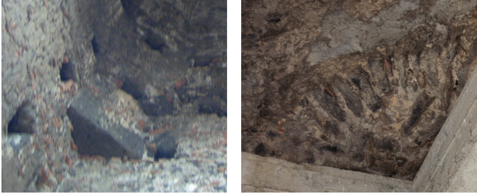
Fig. 103. A sinistra, mensola lapidea posta a 45°, ai piedi dell'intradosso della cuspide bulboide in Santa Maria dell'Aiuto a Catania (Fonte: Carta del Rischio). A destra, pennacchio di imposta della cuspide della SS. Trinità a Bronte.
