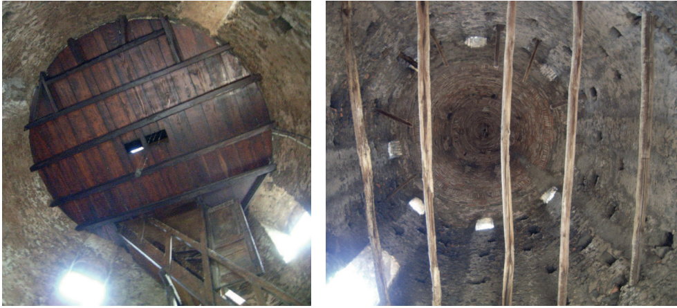
Fig. 93. A sinistra, Orizzontamento dell'ultimo livello di Sant'Agata al Borgo a Catania (Fonte Carta del Rischio). A destra, travi principali del solaio non più esistente nell'ultimo livello di Santa Maria di Monserrato Catania (Fonte Carta del Rischio).
