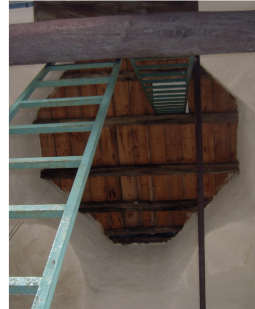
Fig. 101. Solaio dell'ultimo livello del campanile di Sant'Antonio Abate a Pedara.
