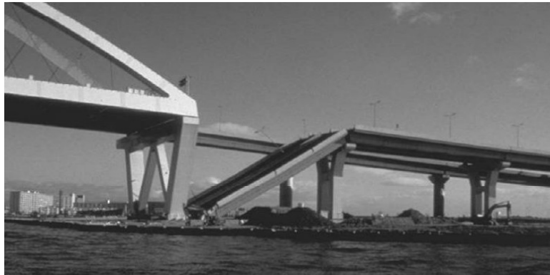
Figura 20 Perdita d'appoggio ponte Nishinomiya-ko, Giappone, Kobe 1995[26]
