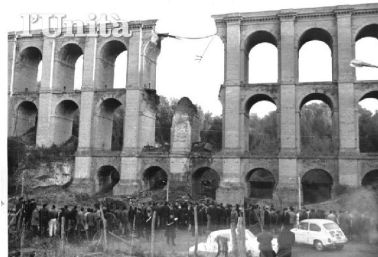
Figura 6 Crollo ponte Ariccia [24]
