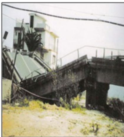
Figura 3 Crollo del Ponte S. Stefano [14]
