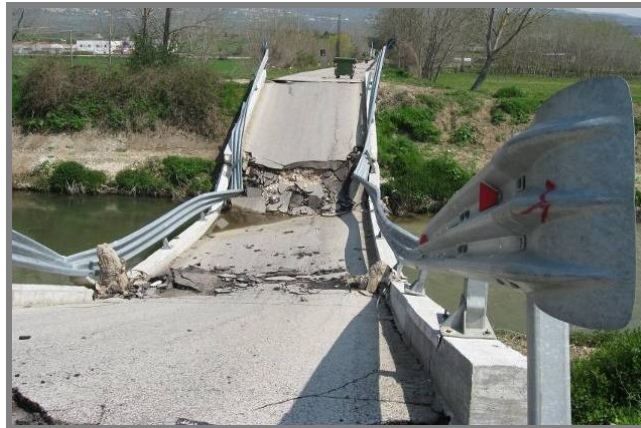
Figura 5 Crollo del ponte sul fiume Aterno [16]
