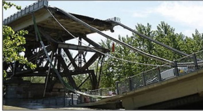
Figura 4 Crollo del ponte sul fiume Po [15]
