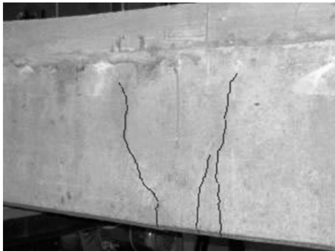
Figura 1.4: Fessurazione di travi in calcestruzzo armato.
