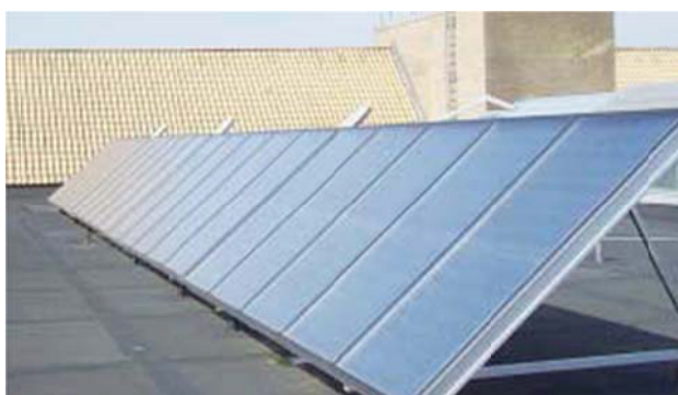
Figura 5.3.14 – Collettori solari in copertura.
