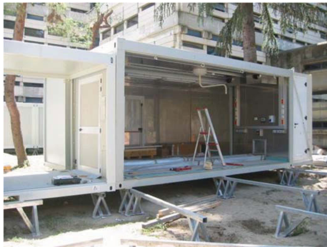
Figura 3.25 – Shelter utilizzato come presidio sanitario per attività operatorie in fase di allestimento
