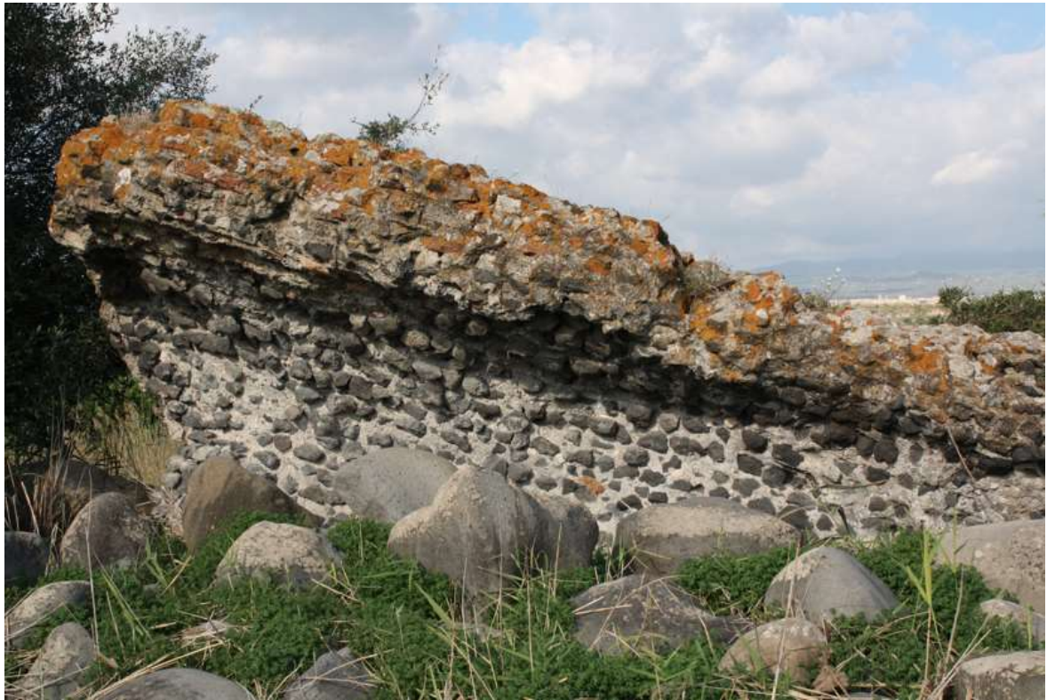
Fig. 40a. Centuripe, ponte romano di contrada Paportello: Pila C, lato sud. Ai piedi della pila i basoli in posizione di crollo. (da DI BENEDETTO 2017).
