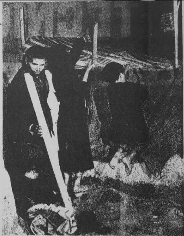
Questo è, oggi, costruire, in Italia: opera primitiva, rimedio da Robinson Crusoe, e certo non ci occorre l'arte del muratore romano. Pure, perché viva, egli ha bisogno che ci occorra la sua arte. (Foto di Margaret Bourke White)
